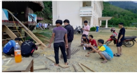
Đoàn trường phối hợp với Công đoàn trường tổ chức sửa chữa nhà Gươl 21/11/2021
